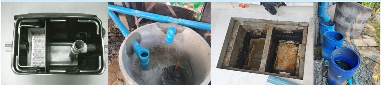
รูปที่ 1-2 รูปแบบถังดักไขมันที่ใช้กันโดยทั่วไป
